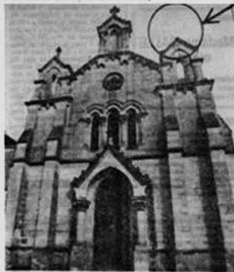
L'église... On voit qu'un élément d'architecture manque : il est tombé dans la rue !
