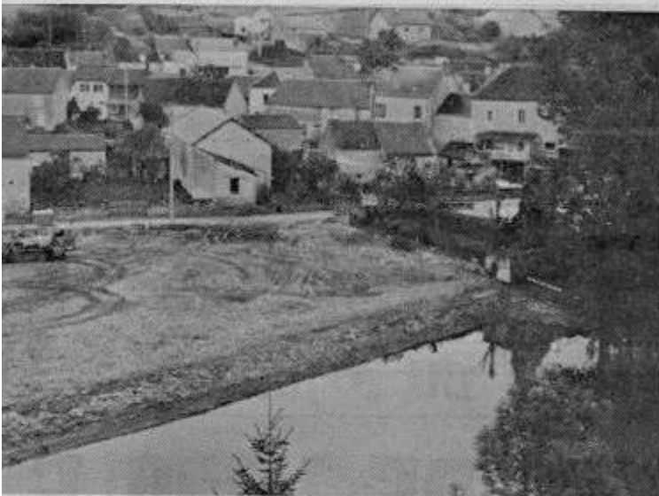
Les travaux du terrain de camping en bordure de la Bouzanne sont activement menés
